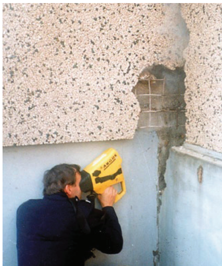
15. August 1996, Brand einer Dehnungsfuge: Suche nach Brandnestern mit der Wärmebildkamera
